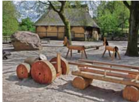
Spielplatz-Sanierung: 130 Kubikmeter Sand wurden ausgetauscht und ein neuer Klettertraktor aus Holz aufgebaut.
